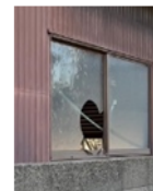
窓が割れた管理不全空家
